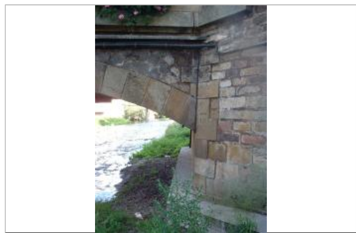
Marque inondation sur le pont charlemagne
