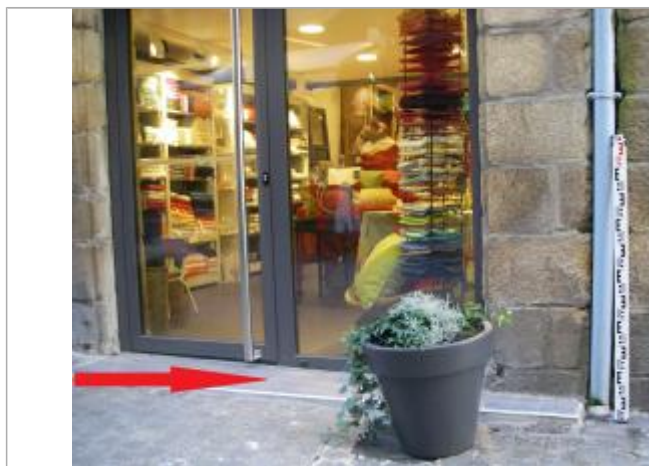
Seuil de la porte d'entrée du magasin - Photographie DHE 2015
