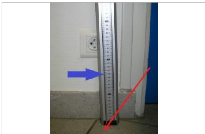
sol à l'intérieur près de la prise électrique
