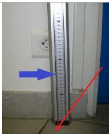
sol à l'intérieur près de la prise électrique
