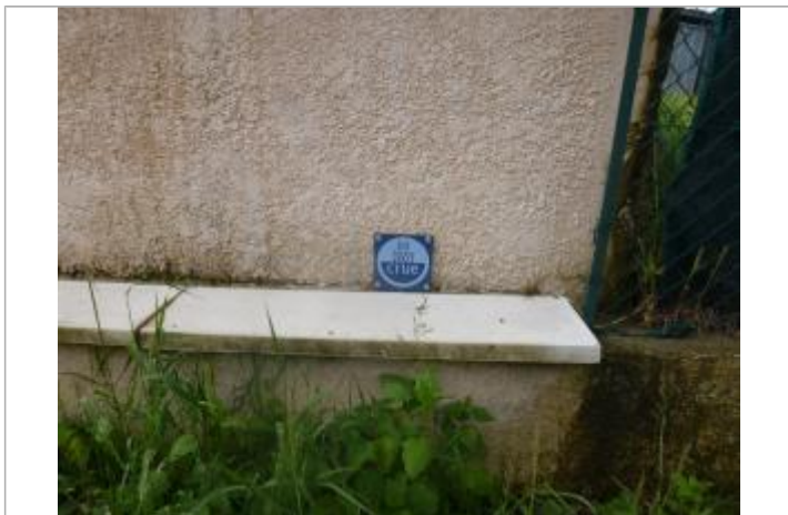
Repère de la crue de 2003 sur le muret.
