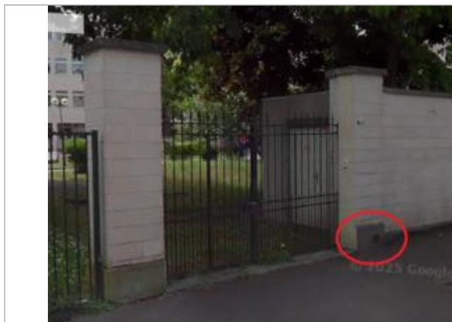
Laisse de crue à 16 cm/sol.
