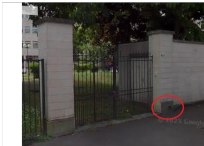
Laisse de crue à 16 cm/sol.
