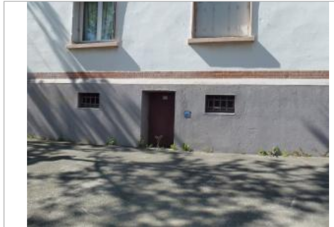
Repère de la crue de 2003 sur le bâtiment OPAC
