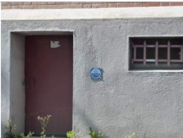
Repère de la crue de 2003 sur le mur du bâtiment OPAC
