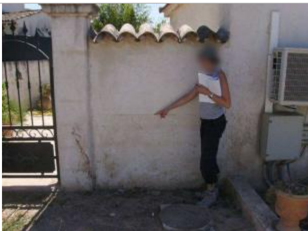
Vue rapprochée - Auteur : EGIS Eau
