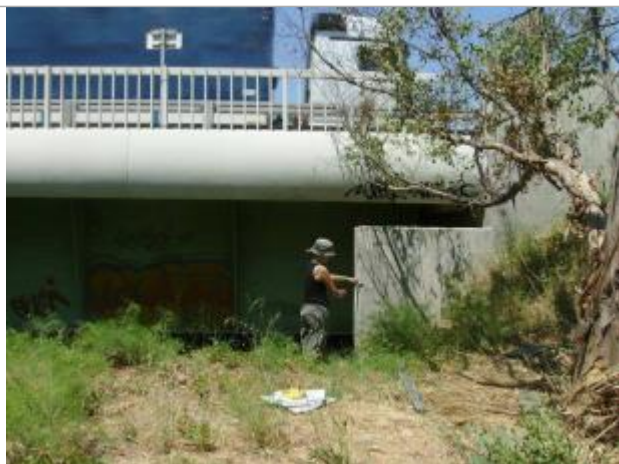
Vue rapprochée - Auteur : EGIS Eau
