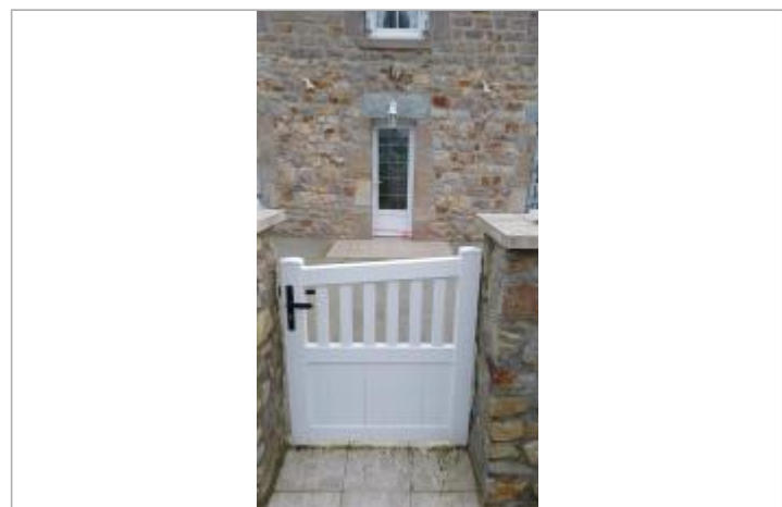
Laisse de crue à 10 cm/sol
