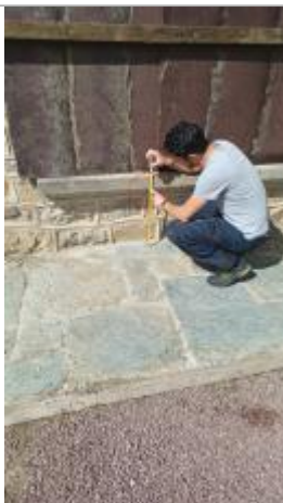
Laisse de crue à 47 cm/sol.
