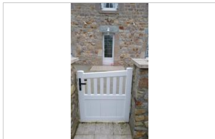
Laisse de crue à 10 cm/sol
