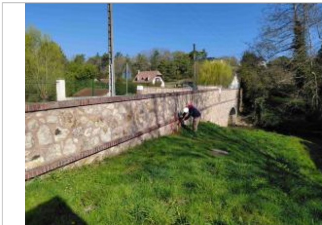
Laisse de crue à 35 cm/sol.
