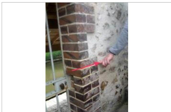
Laisse de crue à 105 cm/sol. (photo SPC SACN)
