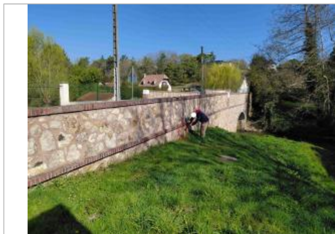
Laisse de crue à 35 cm/sol.
