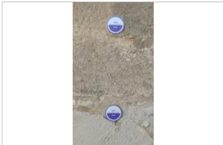
Repère de crue sur l'Arche du passage couvert. Auteur : JLS
