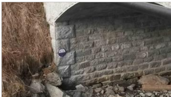
Crue du 24 Juillet 2015
