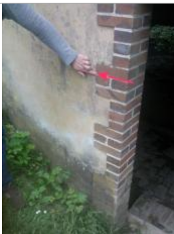
Laisse d'inondation sur le lavoir rue Fervaches (photo SPC-SACN)
