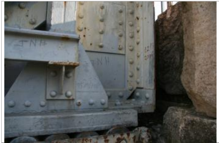
Marquage à la peinture sur le pilier aval côté Ratacan. Auteur: Actions-Coulon
