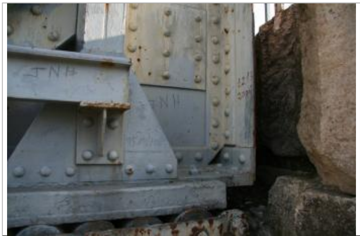
Marquage à la peinture sur le pilier aval côté Ratacan. Auteur: Actions-Coulon
