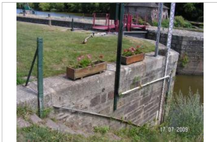
Echelle limnimétrique sur bajoyer aval de l'écluse du Boel
