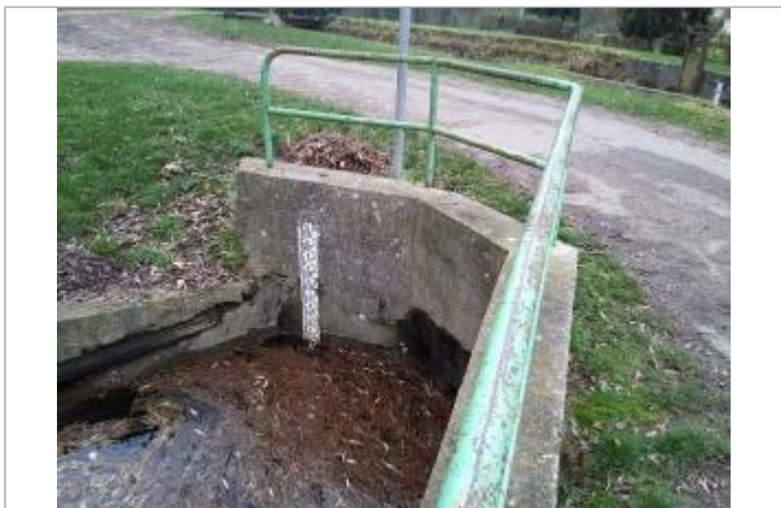
Echelle de crues sur bras annexe à la rivière de St Just
