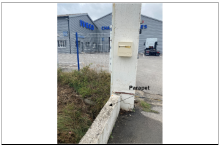
Niveau atteint est 97 cm en dessous du niveau haut du parapet
