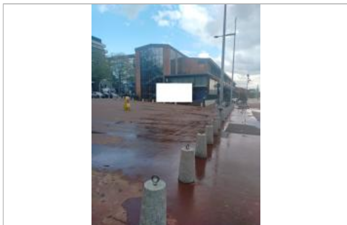
Vue globale sur le sol bitumé des quai proche du hangar 10 (source : SPC SACN)
