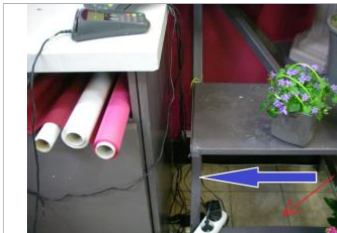
L'eau est arrivée au-dessus de la prise électrique. - Photographie DHE 2015
