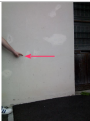
Laisse d'inondation sur la façade du bâtiment (photo SPC-SACN)
