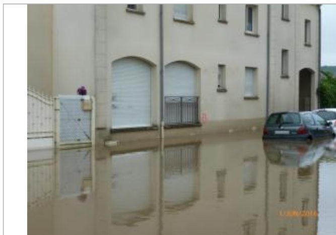
Laisse d'inondation sur la façade du bâtiment (photo DDT 28)
