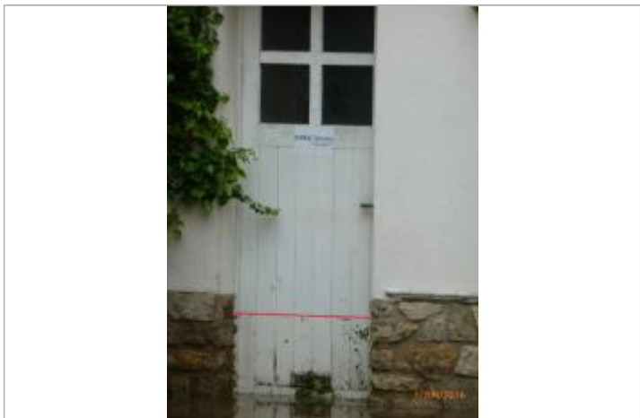
Laisse d'inondation sur la porte arrière (photo DDT 28)
