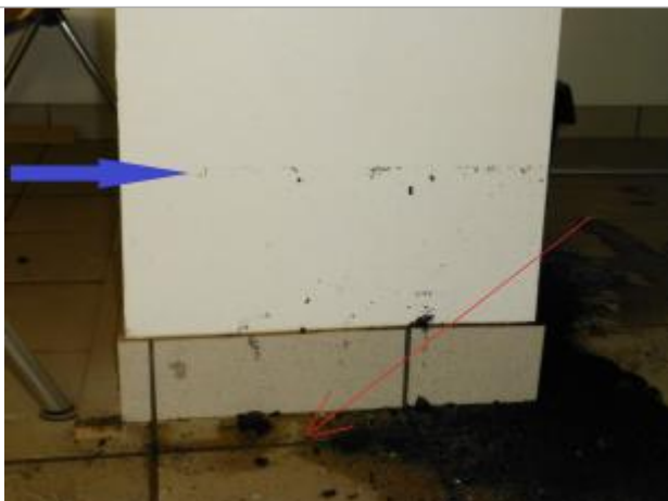
niveau d'eau atteint au dessus du plancher du rez-de-chaussée du bâtiment - Photographie DHE 2015
