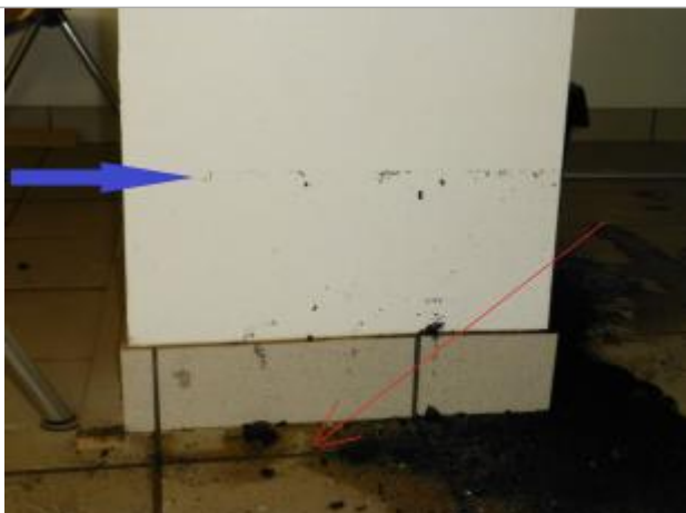
niveau d'eau atteint au dessus du plancher du rez-de-chaussée du bâtiment - Photographie DHE 2015
