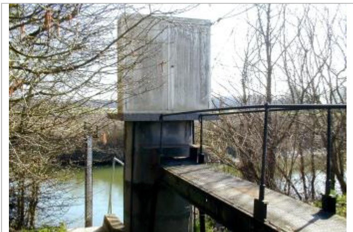
Echelle de crue de Sempigny: chemin de halage du canal latéral à l'Oise
