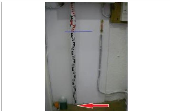
Crue du 06 février 2014 (hauteur depuis le plancher) - Photographie DHE 2015
