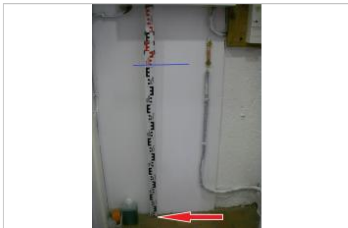
Crue du 06 février 2014 (hauteur depuis le plancher) - Photographie DHE 2015
