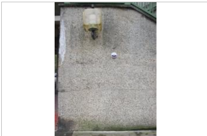
Repère n°4, Pied de l'escalier menant à la N4, coté quai de Polangis
