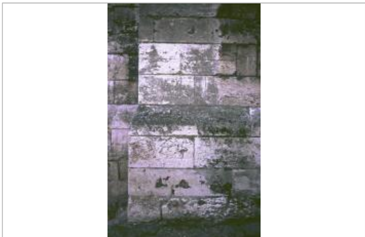
Inscriptions niveaux inondations 1658 sur contrefort sud-ouest LD février 2011 - auteur photo : Mr DUMARCHE
