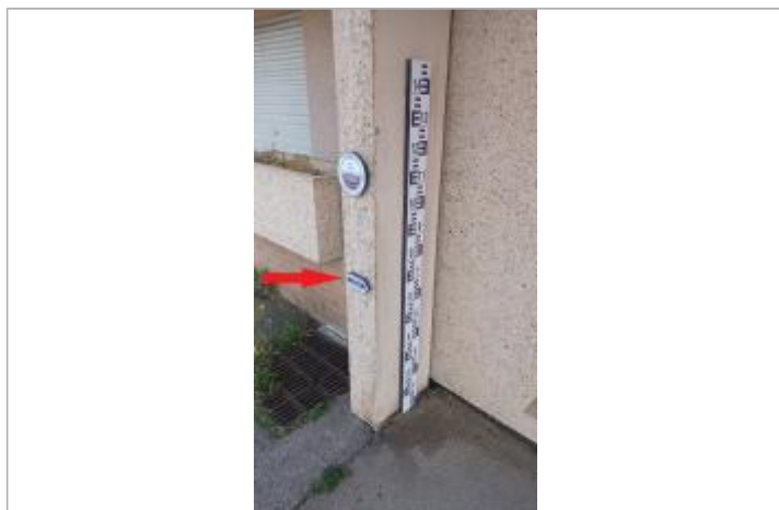
Laisse de crue à 72 cm/sol
