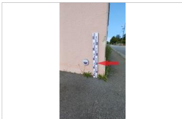
Laisse de crue à 44 cm/sol.
