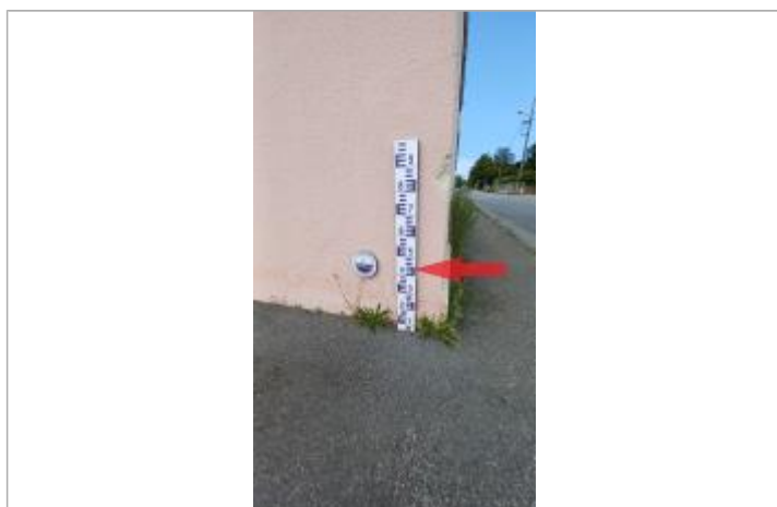
Laisse de crue à 44 cm/sol.
