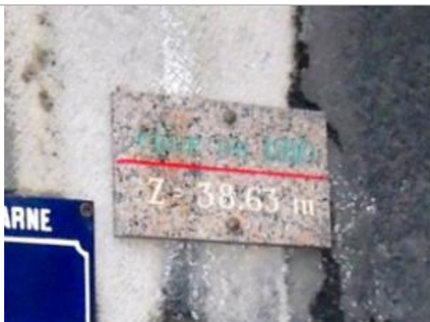
Plaque indiquant le niveau de la crue de la Marne de 1910 à Nogent-sur-Marne . - auteur photo : Inconnue
