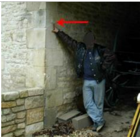
Repère de crue du 27/04/1998 - auteur photo : SOGREAH
