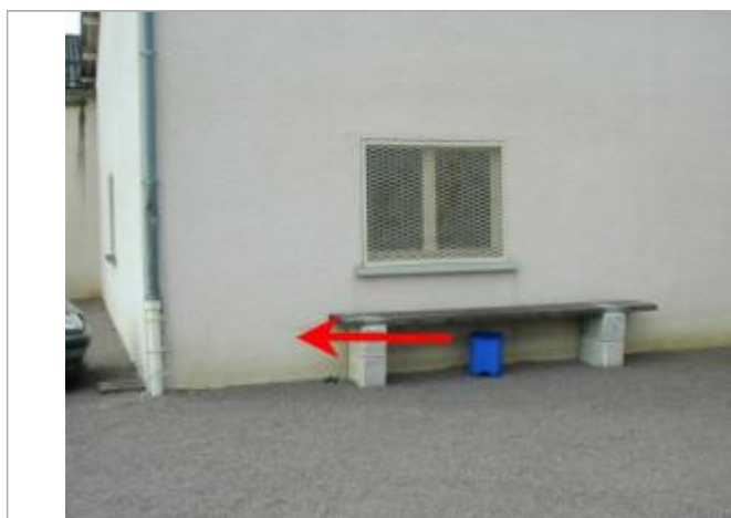
Niveau atteint en mars 2001 - auteur photo : SOGREAH
