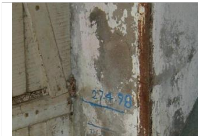
Repère de crue de 1998 - auteur photo : SOGREAH
