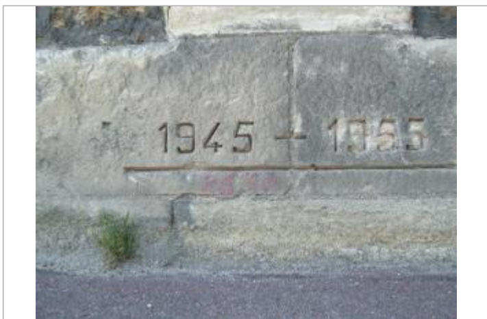
Repère de crue de 1945/1955 - auteur photo : DIREN IDF
