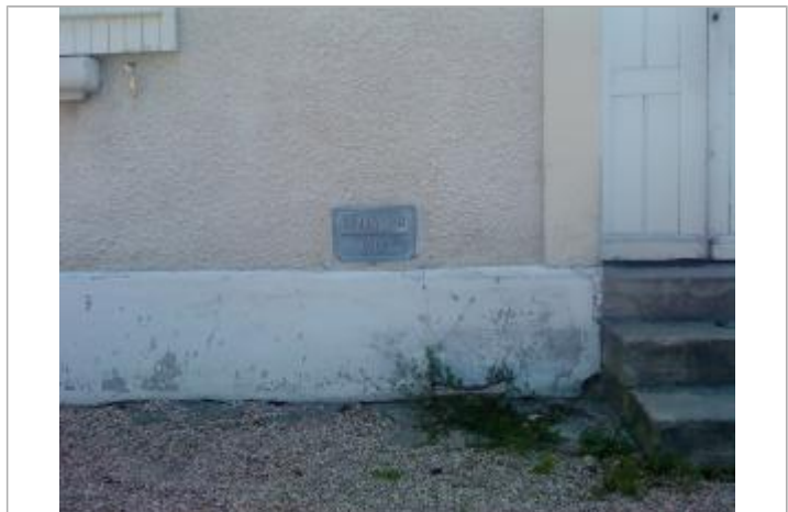
Repère de crue de 1955 - auteur photo : DIREN IDF
