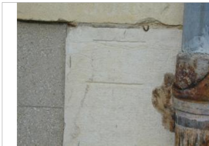
Repères de crue non datés - auteur photo : DIREN IDF
