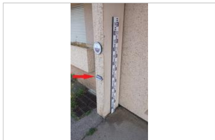
Laisse de crue à 72 cm/sol
