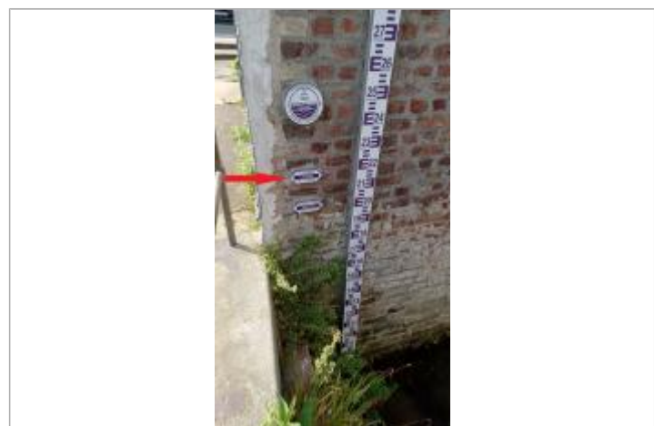
Laisse de crue à 2.2 m/sol.
