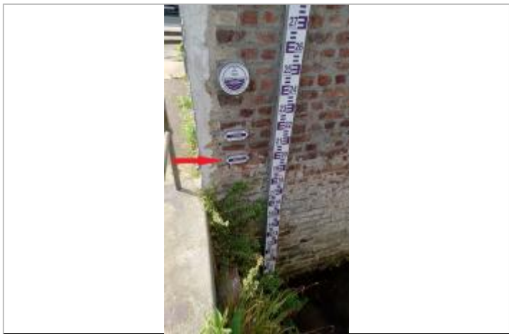
Laisse de crue à 2.04 m/sol.
