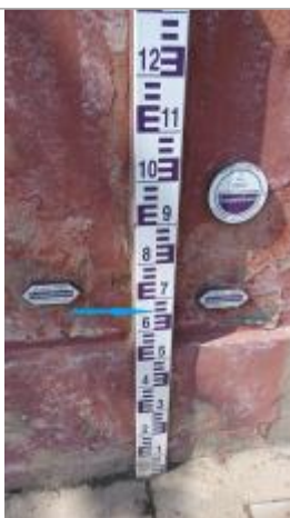
Laisse de crue à 61 cm/sol
