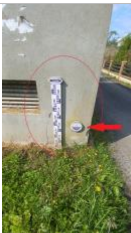
Laisse de crue à 49 cm/sol.
