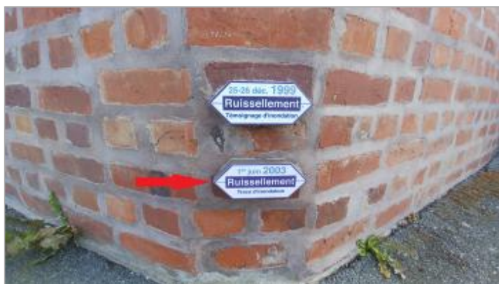
Laisse de crue à 24 cm/sol
