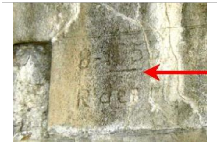
Repère de crue de 1955 - auteur photo : SOGREAH
